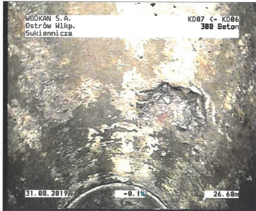
Zdjęcie: 12_1_7_31082019_122437_A.JPG 26,99m, Uszkodzenia powierzchni, o 12 godz.
