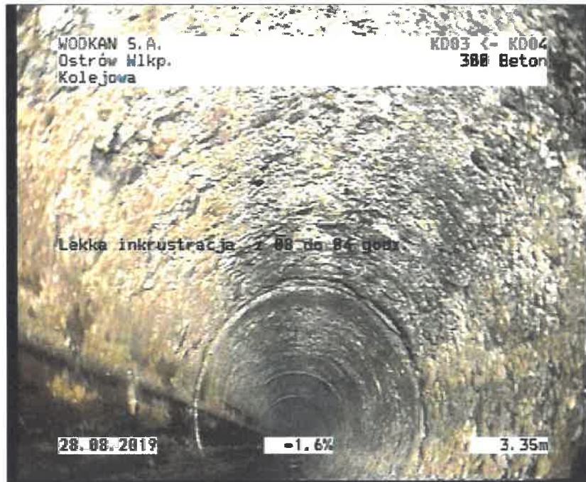
Zdjęcie: 5_1_3_28082019_083040_B.JPG 3,35m, Lekka inkrustracja z 08 do 04 godz.
