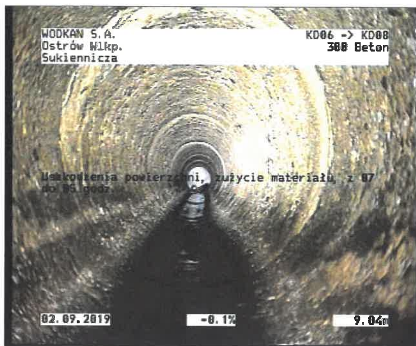
Zdjęcie: 13_1_3_02092019_085128_A.JPG 9,03m, Uszkodzenia powierzchni, zużycie materiału, z 07 do 05 godz.
