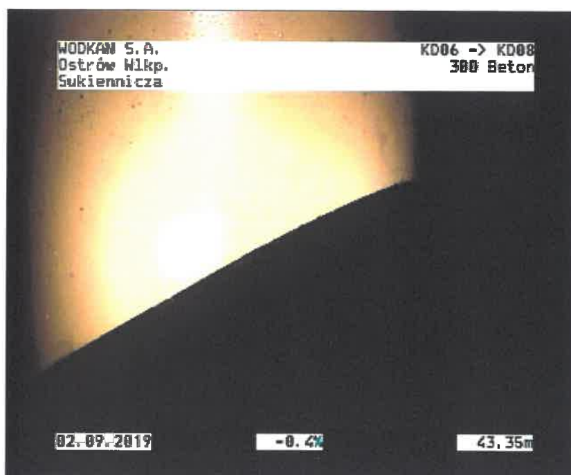
Zdjęcie: 13_1_8_02092019_085951_A.JPG 43,35m, Rezygnacja z inspekcji
