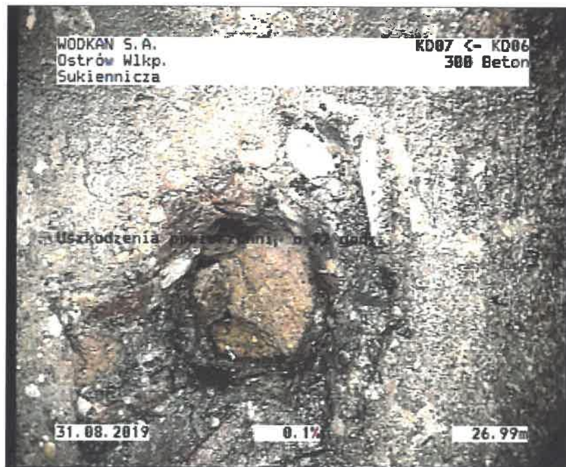
Zdjęcie: 12_1_7_31082019_122418_B.JPG 26,99m, Uszkodzenia powierzchni, o 12 godz.
