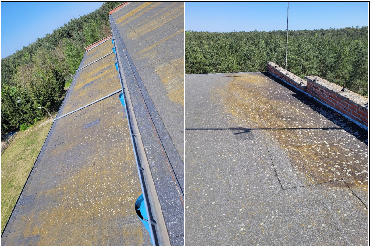
widoczne pofałdowania papy i korozja
